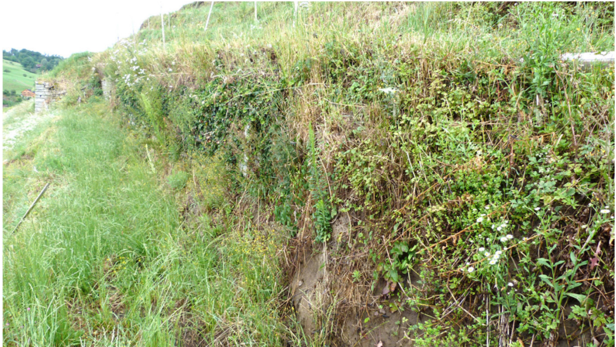
Abb. 5: Ausgangszustand. Die Trockenmauer ist stellenweise eingestürzt und wird nach unten versetzt, so dass Sie in die Flucht der bereits sanierten Trockenmauer 15 (Bildhintergrund links) zu liegen kommt.
