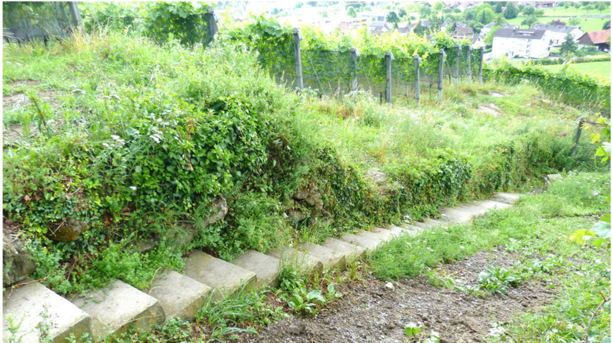
Abb. 1: Ausgangszustand. Die Trockenmauer 11 ist kaum hintermauert. Abschnittsweise werden die Steine nur noch durch den Efeubewuchs im Verband gehalten.
