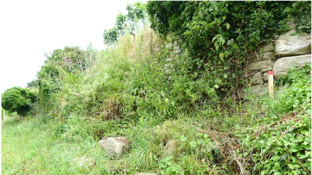
Abb. 9: Ausgangszustand. Die Trockenmauer 14b ist grösstenteils eingestürzt. Der Zeigerpfahl markiert die Parzellengrenze bzw. den Anschluss an die Trockenmauer 14.
